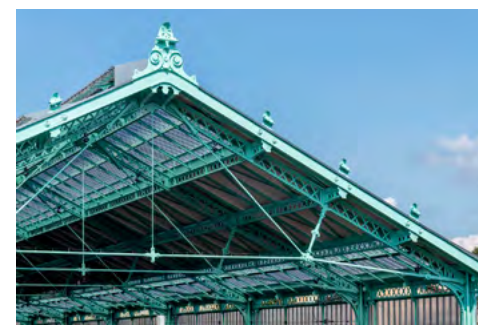
Restauration de la grande halle voyageurs de la gare de Valence, détail du tympan, 2023
